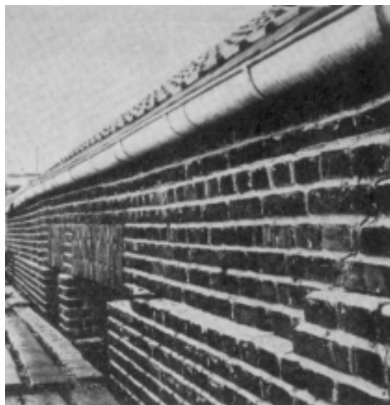
Fig. 6. Frostskalet facade i en bygning med bærende tværskillerum. Nederste del af facademurene er skudt ud af frosten, der er trængt ind i bygningen gennem ubeskyttede dør- og vinduesåbninger og har løftet fundamentene indefra.
