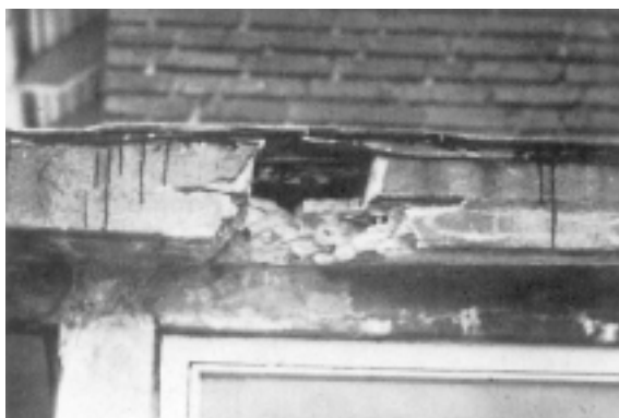
16 og 17 Totalt nedbrudt jernbeton-tag.
