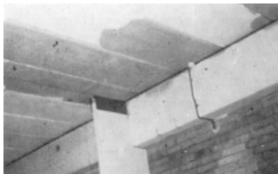
27 Vandskader efter løsnet tagpap.
