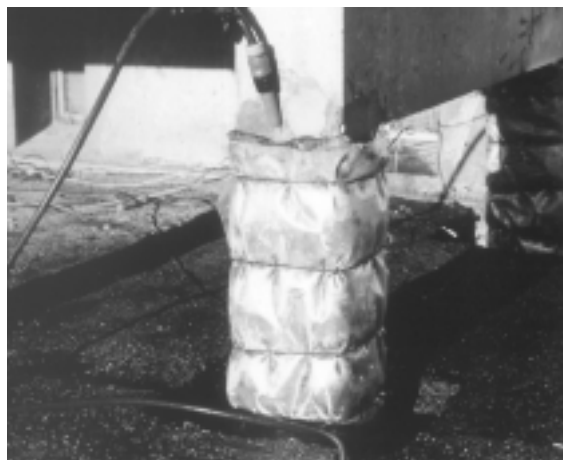
Fig. 8. Søjler, der skal realkaliseres eller afsaltes (chloridudtrækning), omvikles med gennemvædet tekstil (elektrolyt), hvori anoden placeres.
